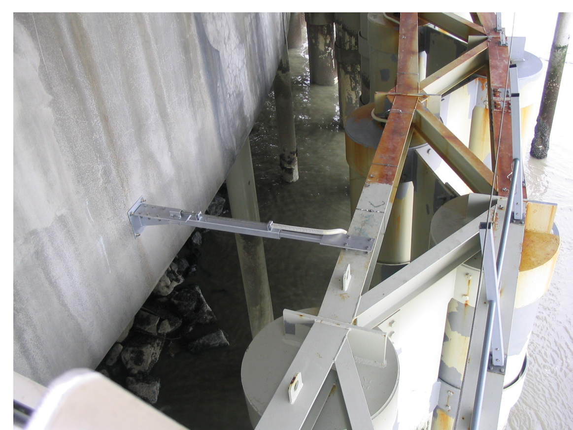
Blankenberge pier - Displacement
